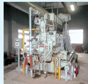
自家発電機 (昭和47年設置)
