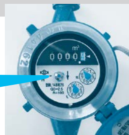
水道メーター
