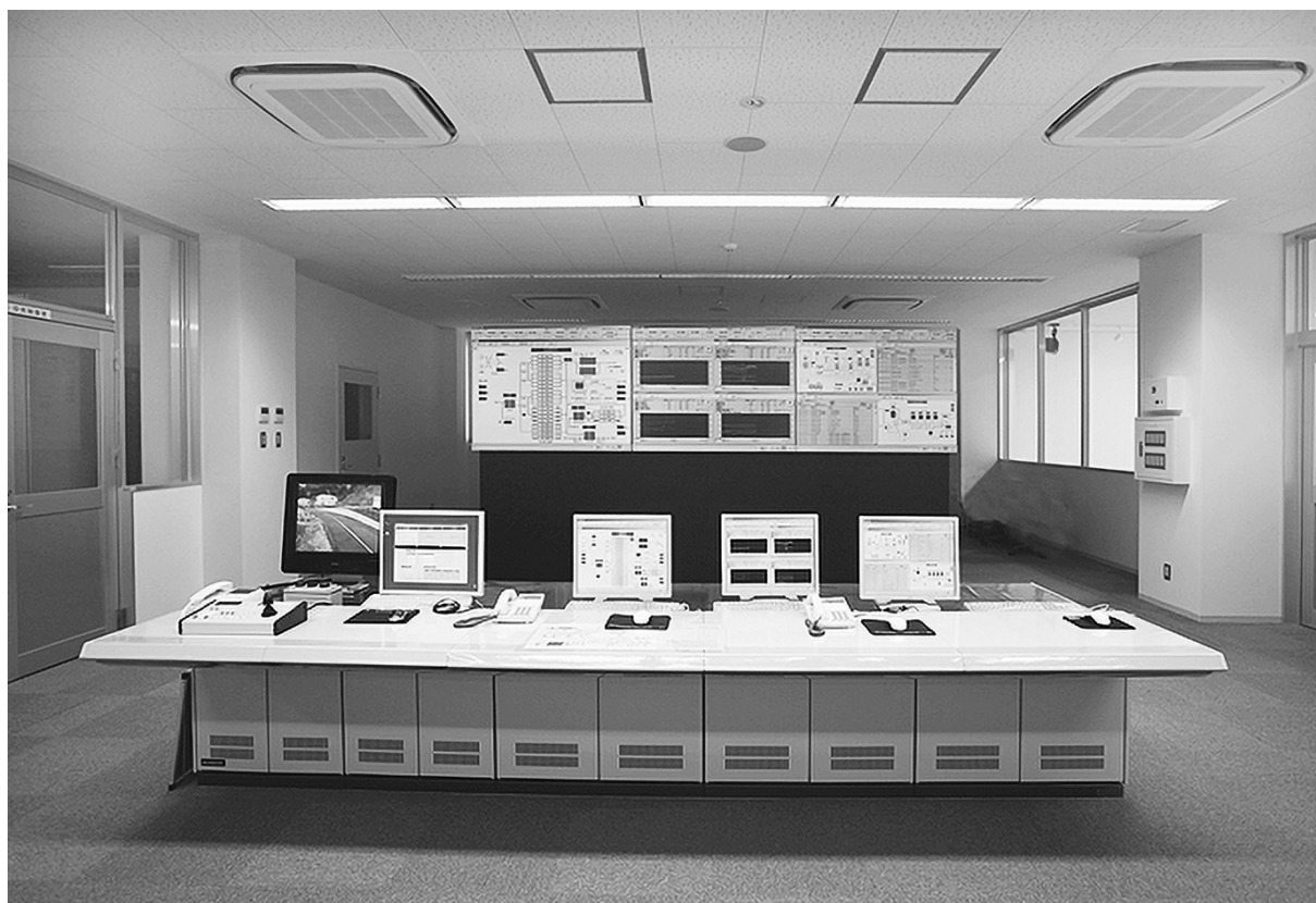
江山浄水場 中央監視室
