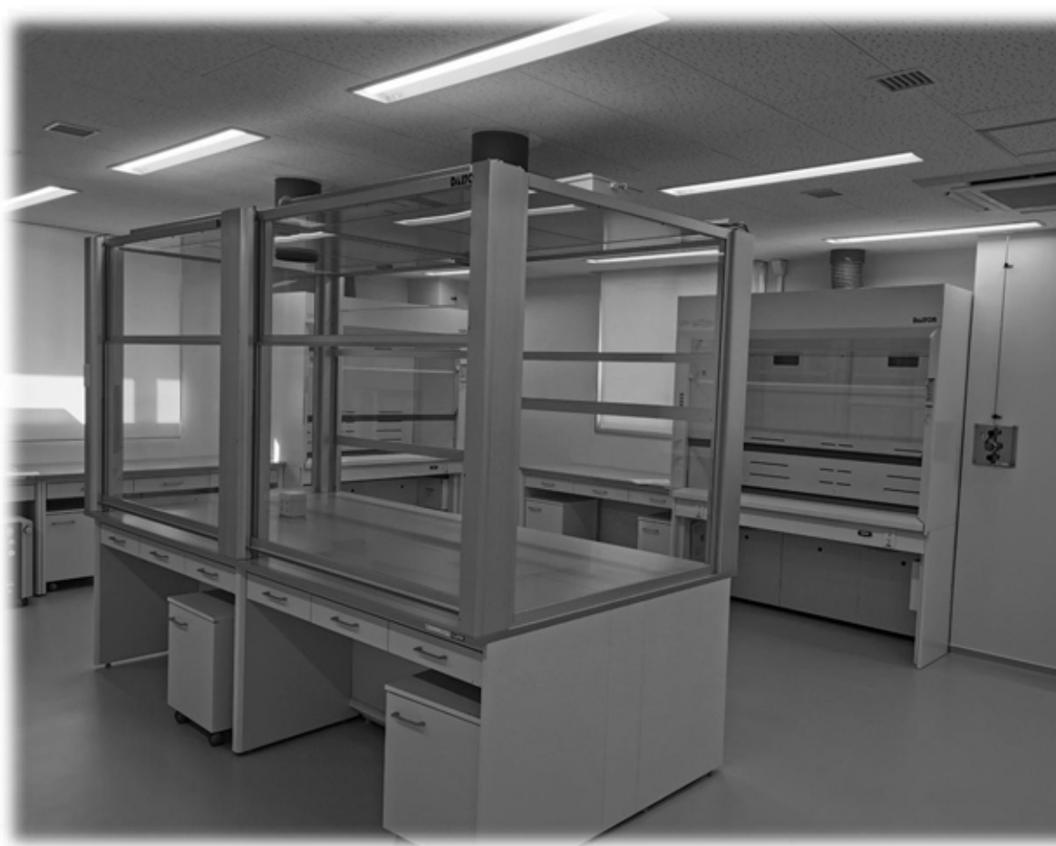
囲い式フード・ドラフトチャンバー（有機物前処理室）
